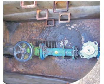
Einer von zwei Druckminderern, die im Schacht für den richtigen Druck sorgen werden.
