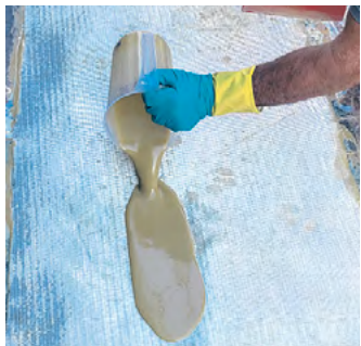
Vor Ort schneiden die Fachleute dann ein schadengroßes Stück Glasfaser-Laminat zu und tränken es beidseitig mit Komponentenharz.
