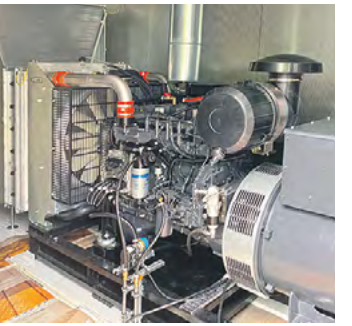
Moderne Technik für den Ernstfall – das neue Notstromaggregat des KMS im Wasserwerk Rangsdorf.
